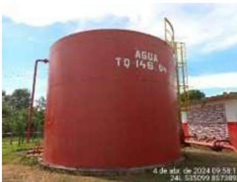
Imagem 11: Tanque de Armazenamento de água (TQ-3146-01-04)
