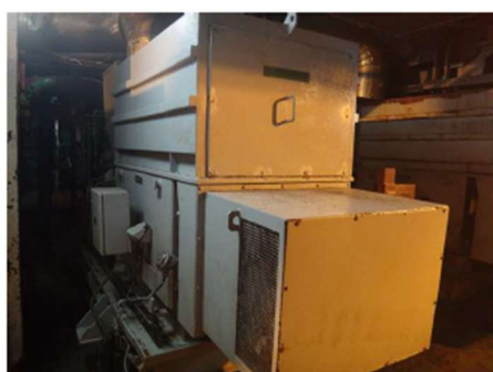
Bomba Booster de Injeção de Água B - 125101B
