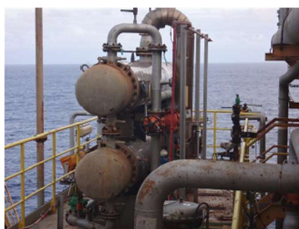
Permutador do compressor booster - P-122304
