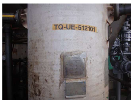
Tanque da Unidade de Eletrocloração - TQ-UE-512101
