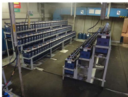
Sala de Baterias
