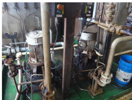
Bombas Sistema de Glicol - B-612502-A/B
