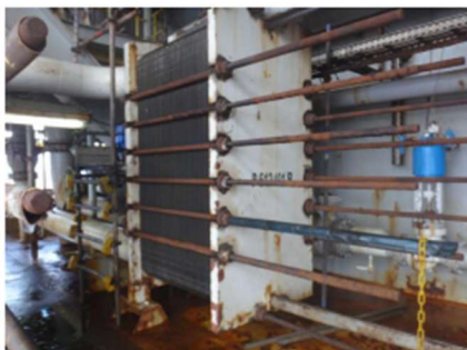
Permutador de Água de Resfriamento - P-512401-B
