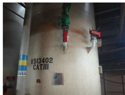
Vaso do Sistema Ar comprimido V-513402
