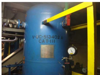
Vaso da Unidade compressora - V-UC-513402A
