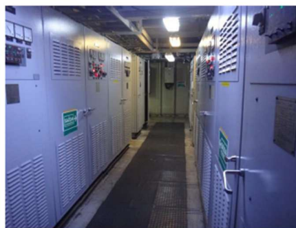
Sala dos Carregadores de Baterias - UPS
