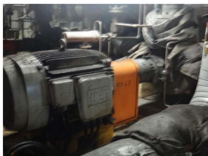
Bomba Circulação Água Quente
