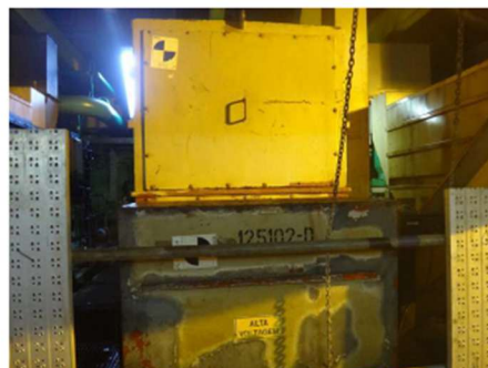
Bomba de Injeção de Água - B-125102-D
