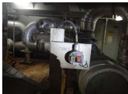
Bomba Circulação Água Quente
