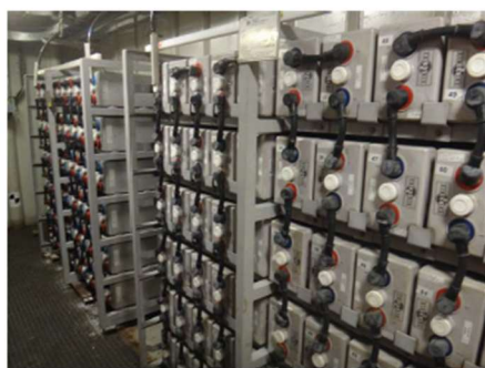
Sala de Baterias dos TG e TC
