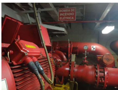
Bomba de Incêndio Elétrica
