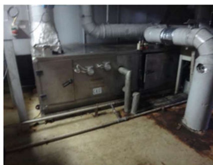
Sala de VAC 5
