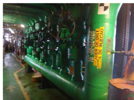
Header distribuição Água de Injeção
