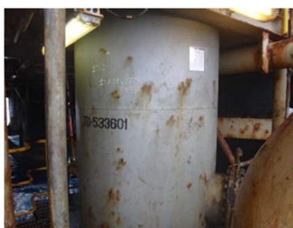
Tanque de drenagem dos pisos operacionais
