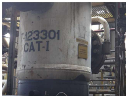
Torre de Glicol - 123301
