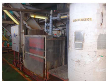
Skid de Eletrocloração
