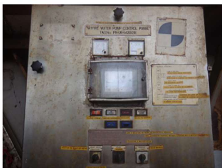
Painel da Bomba de Combate Incêndio - MB-542001B
