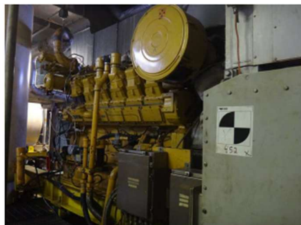
Moto Gerador - MG-GE-514002A
