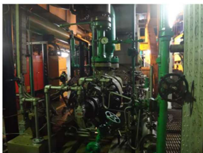
Unidade Hidráulica dos reservatórios
