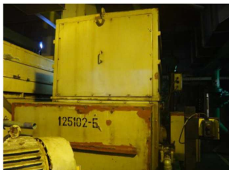
Bomba de Injeção de Água B-125102-E
