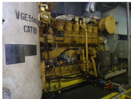
Moto Gerador MG-GE-514002B
