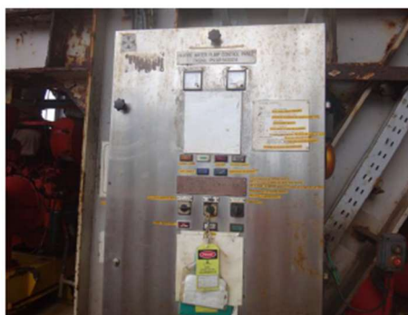
Painel da Bomba de Combate Incêndio - MB-542001A
