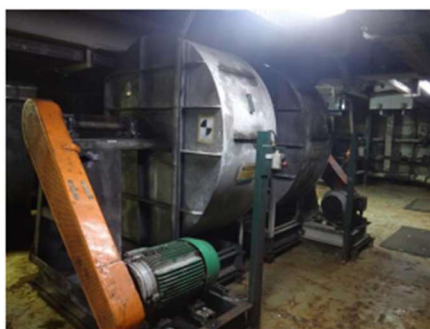
Ventilador Sala do VAC 4
