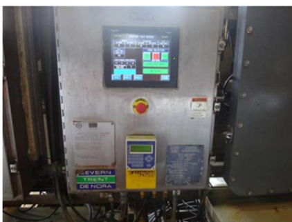
Sistema Tratamento Água Oleosa - UT 531201
