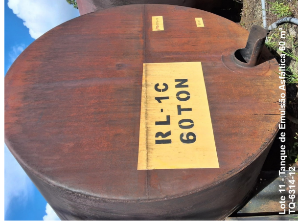
10 - Tanque de Emulsão Asfáltica 60 m³ TQ-6314-10
