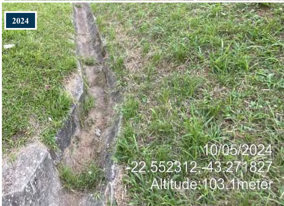
Figura 14: Comparativo entre as canaletas de drenagem danificadas durante as inspeções de 2023 e 2024.
