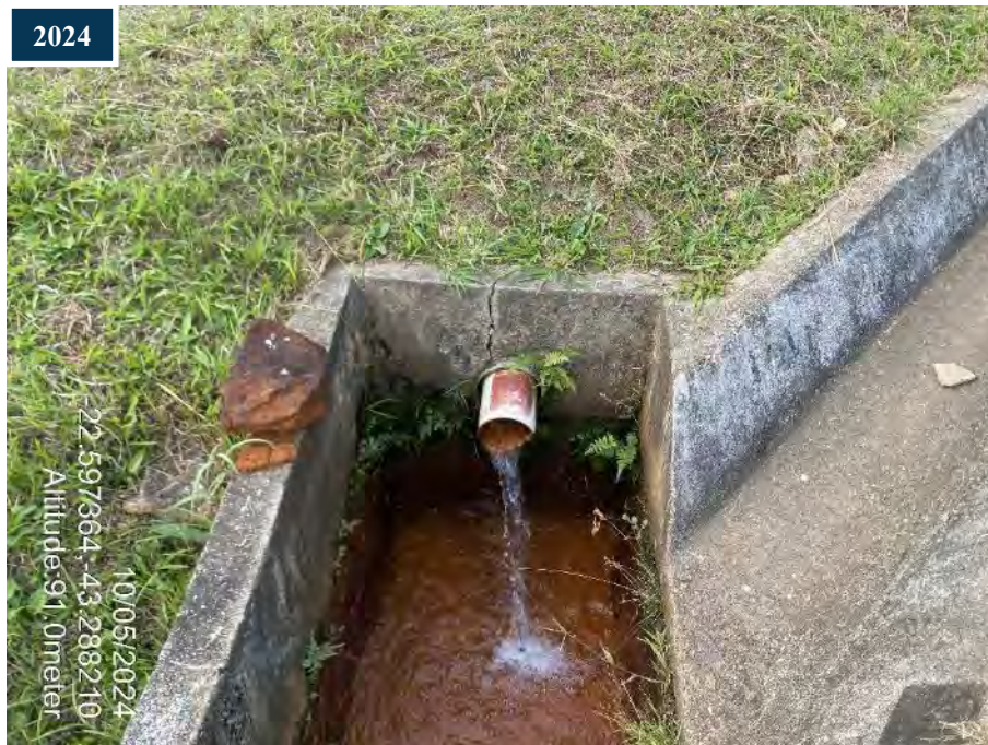
Figura 18: Comparativo entre a presença de material na saída dos drenos registrada nas inspeções de 2023 e 2024.
