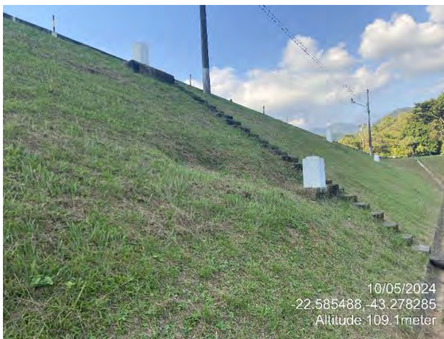
Figura 13: Cicatriz de afundamento no talude próximo a berma superior.
