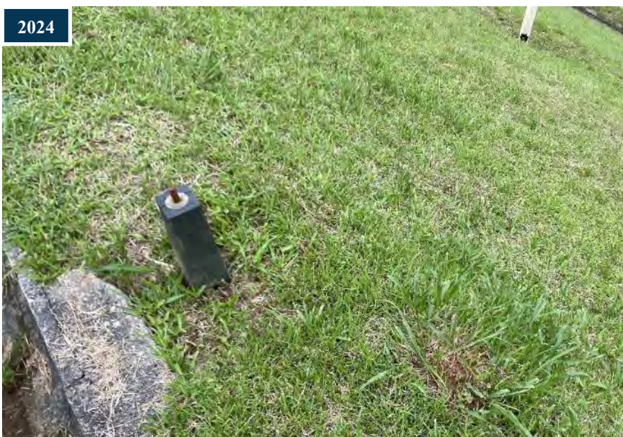
Figura 26: Comparativo entre marcos topográficos de monitoramento com fissura e barra enferrujada durante as inspeções de 2023 e 2024.
