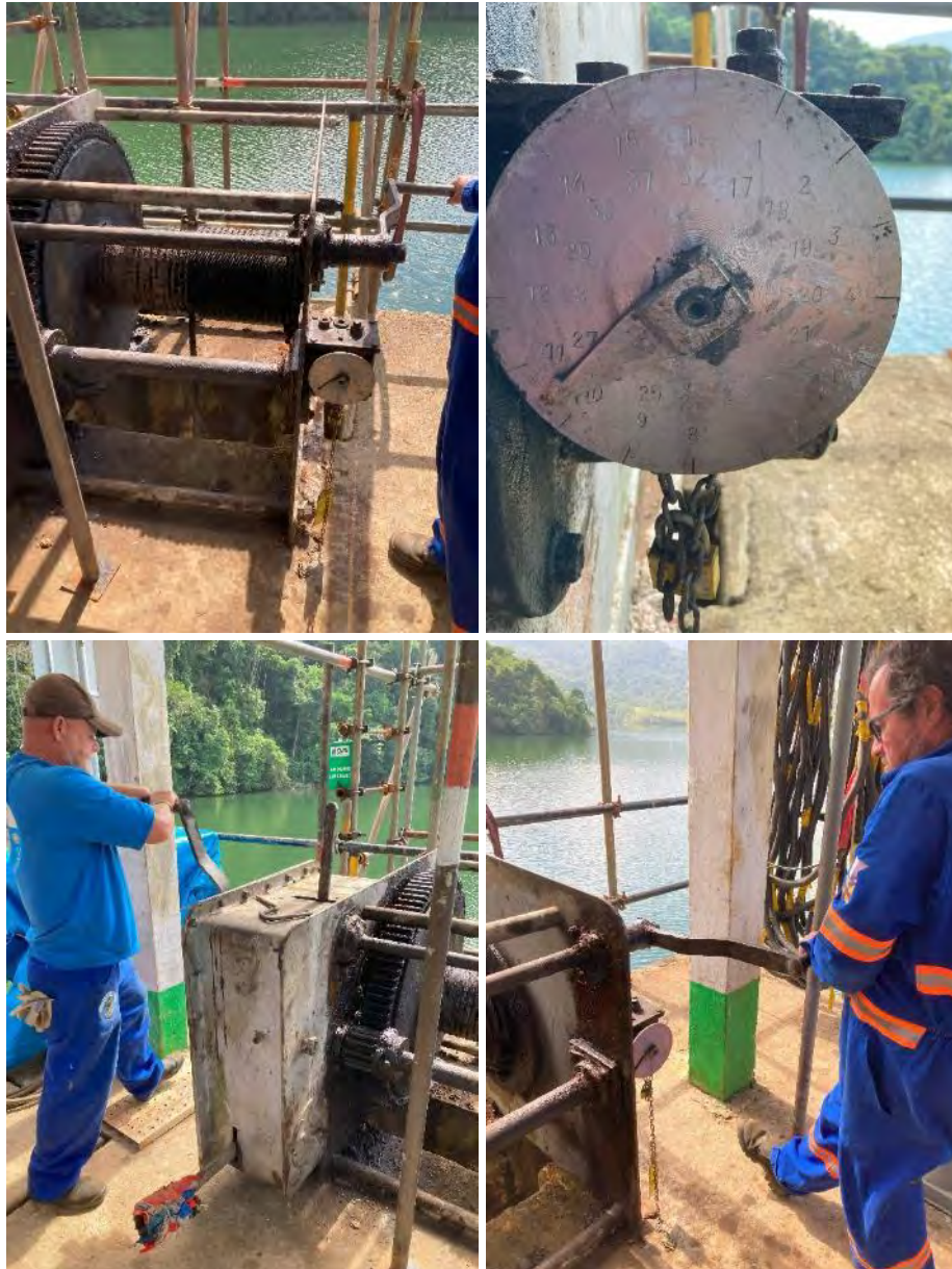
Figura 49: Sistema de acionamento manual da comporta vagão da descarga de fundo.
