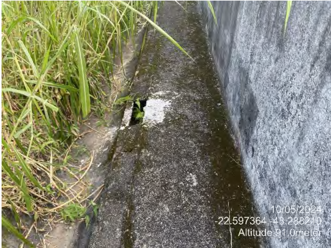
Figura 59: Buraco no concreto atrás do muro lateral da bacia de dissipação, indicado que pode estar havendo erosão no solo onde o muro está apoiado.
