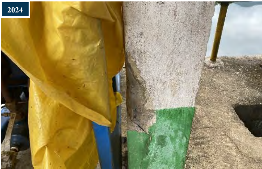
Figura 50: Comparativo da fissura no pilar da cobertura da torre durante as inspeções de 2023 e 2024.
