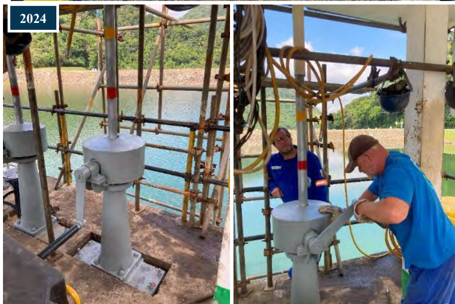
Figura 48: Comparação do sistema de acionamento da comportas do sistema de adução durante e após a manutenção.
