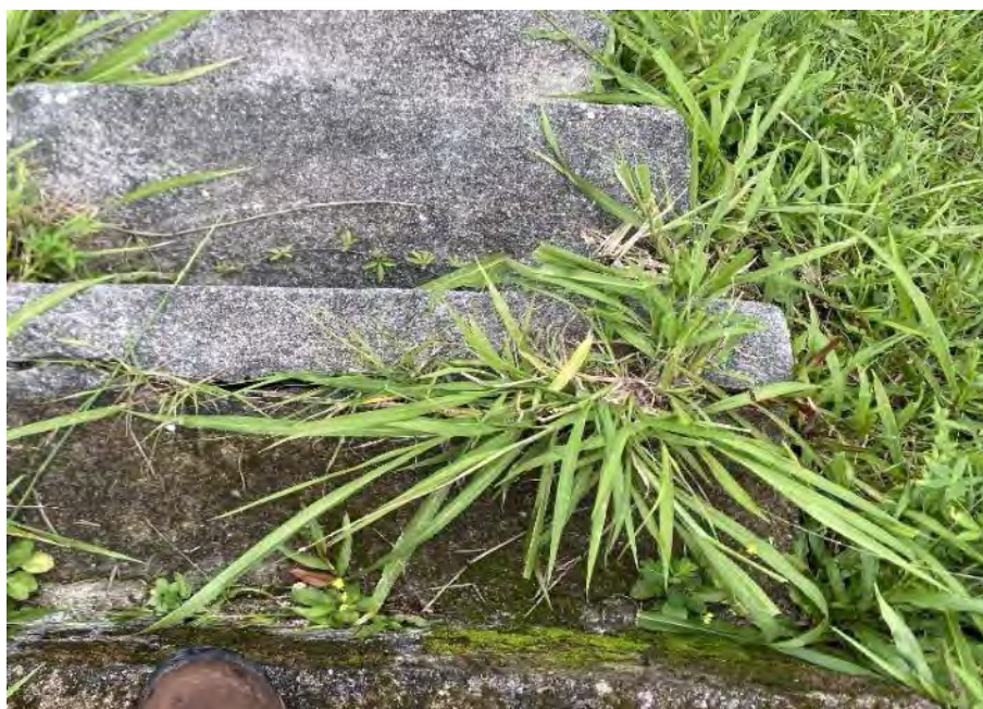
Figura 28: Escada de acesso íngreme se encontra deteriorada.
