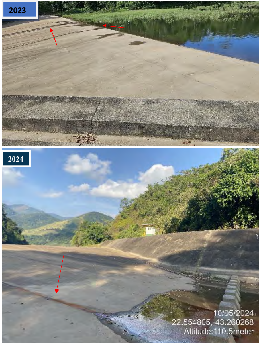
Figura 41: Comparativo entre as fissuras e juntas de concretagem danificadas na soleira durante.
