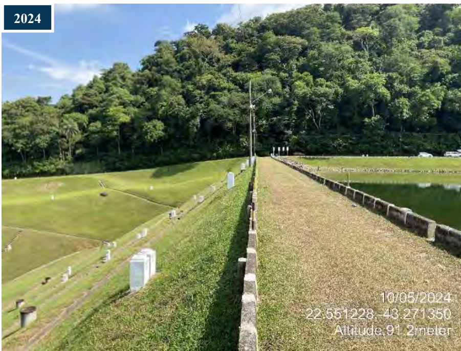
Figura 11: Comparativo entre o desalinhamento do meio fio durante as inspeções de 2023 e 2024.
