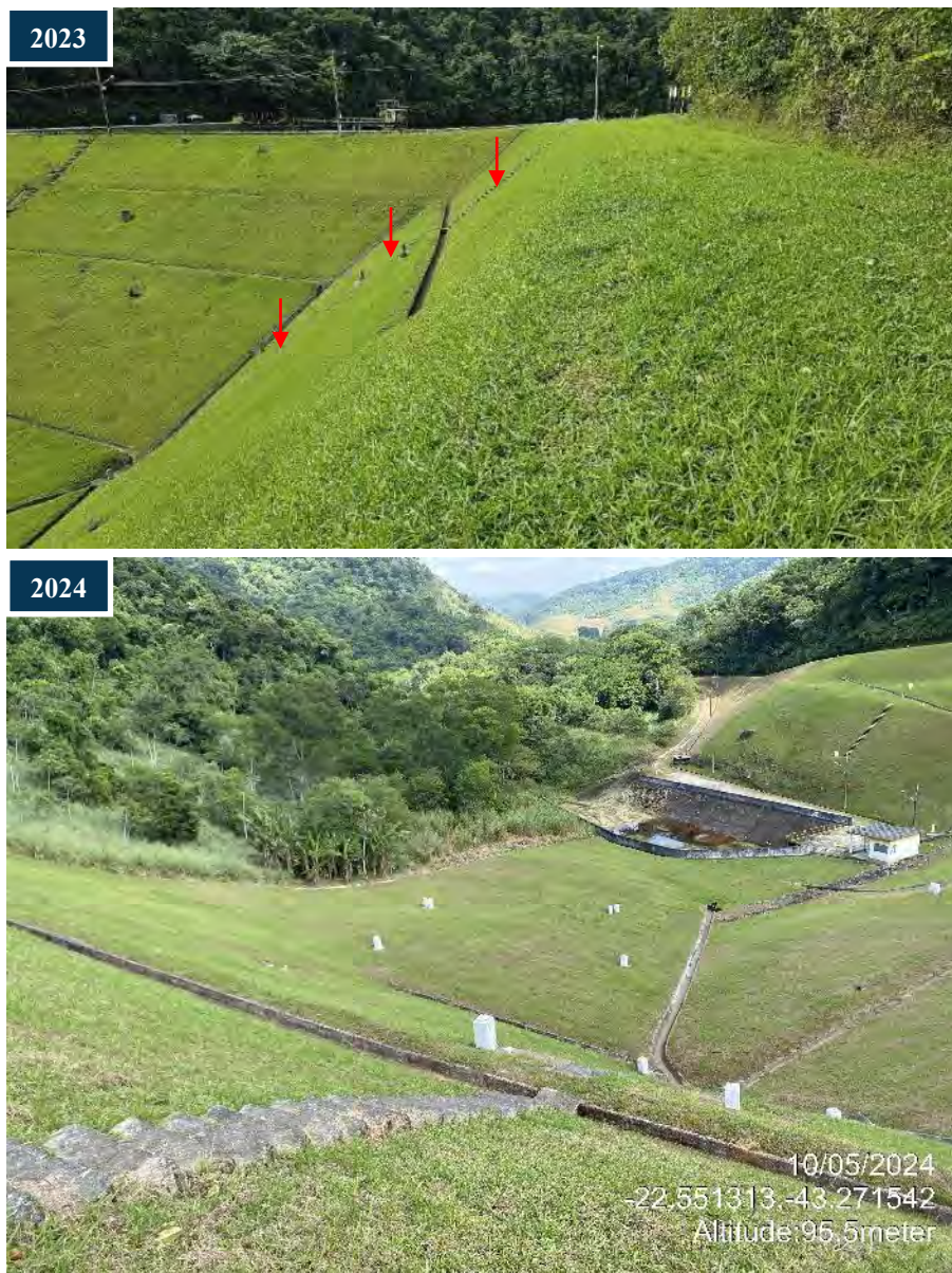
Figura 24: Escadas íngremes sem corre mão, expondo os operadores ao risco durante a leitura dos instrumentos, observadas durante as inspeções de 2023 e 2024.
