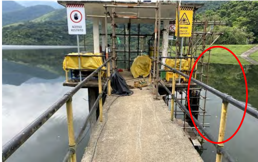
Figura 53: Guarda corpo da passarela de acesso se encontra com a pintura danificada.
