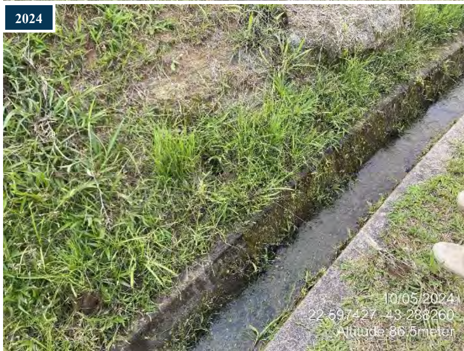
Figura 19: Surgência no pé da ombreira direita da barragem.
