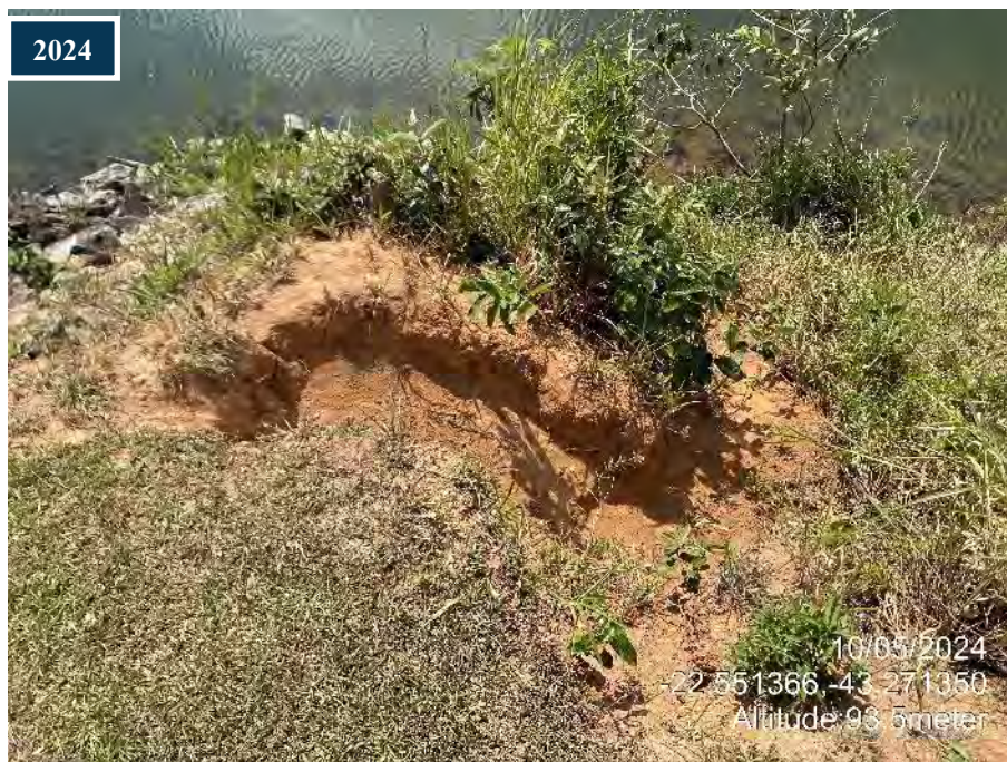
Figura 30: Comparativo entre a erosão na ombreira esquerda a montante durante as inspeções em 2023 e 2024.
