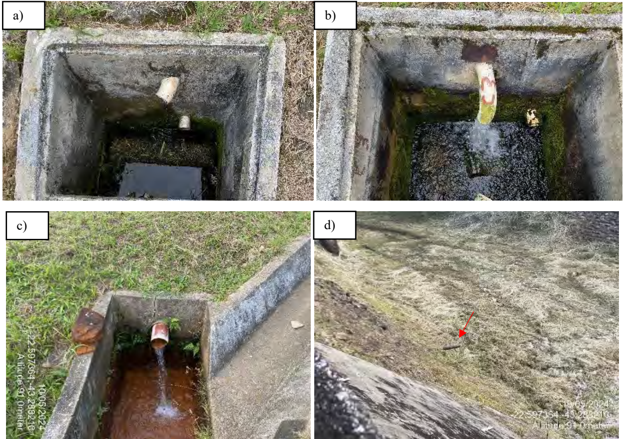
Figura 29: Dreno coletores para medição da vazão. Atualmente o Dreno C2 (Figura 25a) apresenta-se gotejando.
