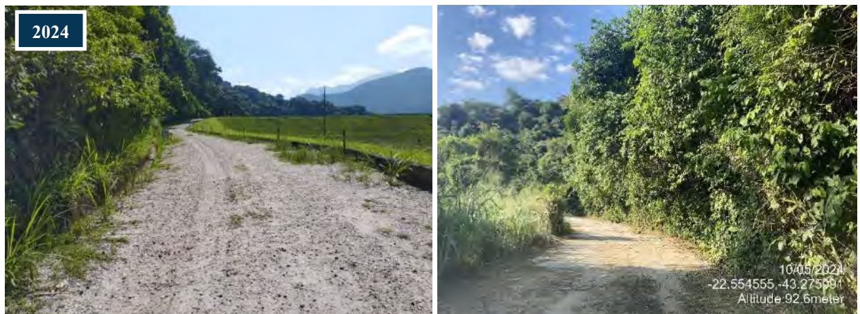
Figura 1: Comparativo entre a erosão observada na estrada de acesso durante as inspeções de 2023 e 2024.
