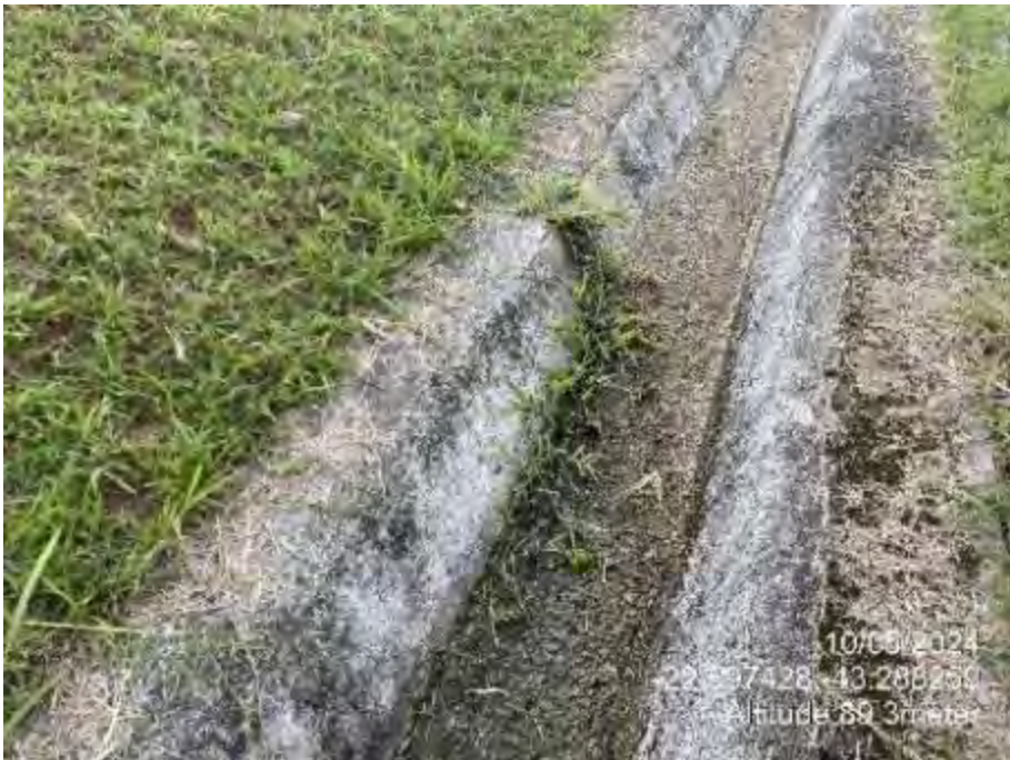
Figura 16: Existência de surgência na descida d’água localizada no encontro do talude de jusante com a ombreira direita de jusante.
