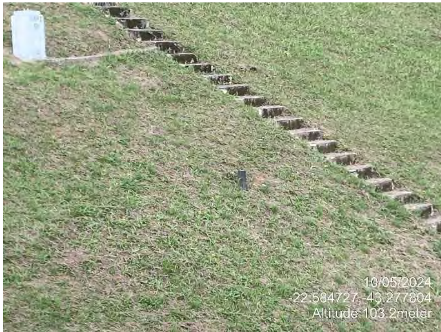
Figura 27: Marco topográfico com difícil acesso, sem corrimão da escada e sem patamar de apoio para monitoramento
