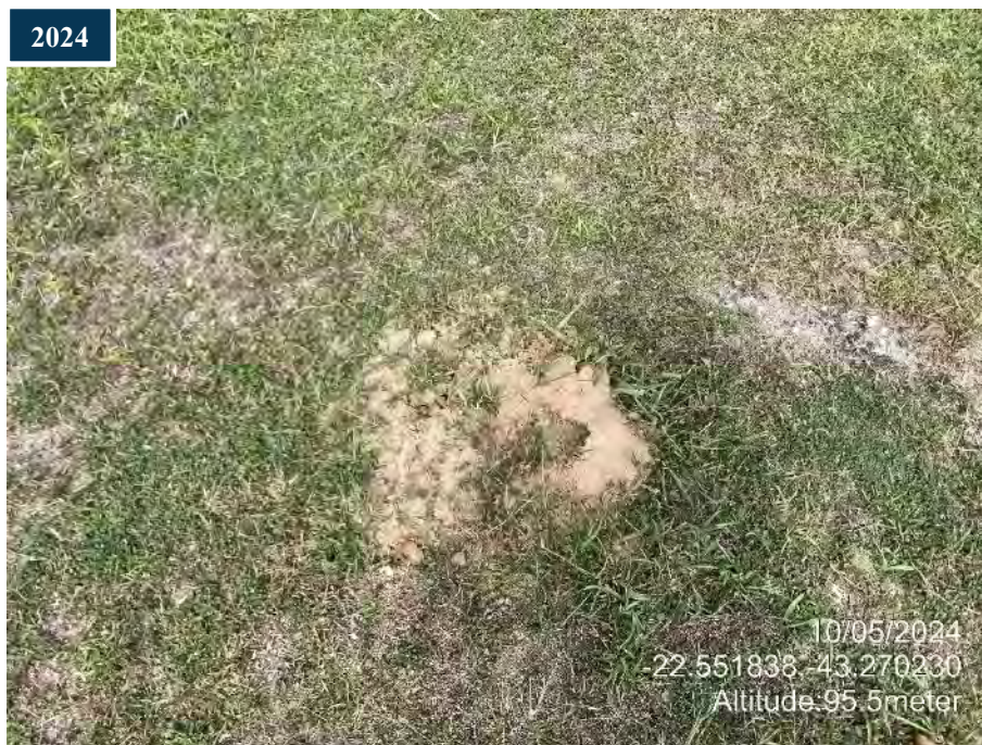
Figura 34: Comparativo entre formigueiro na ombreira esquerda a montante durante as inspeções de 2023 e 2024.
