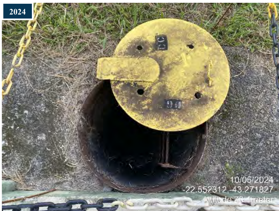
Figura 21: Comparativo entre a situação do acesso ao poço durante as inspeções de 2023 e 2024.
