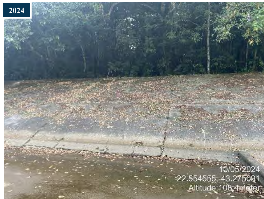
Figura 43: Comparativo entre as fissuras e deterioração observadas durante as inspeções de 2023 e 2024.
