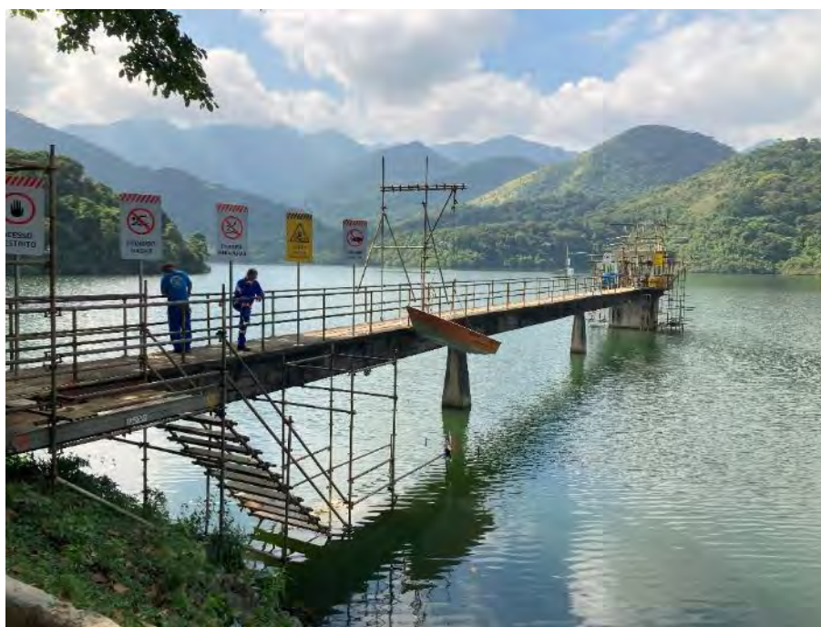
Figura 4: Torre de tomada d'água sem qualquer estrutura de iluminação de energia elétrica.
