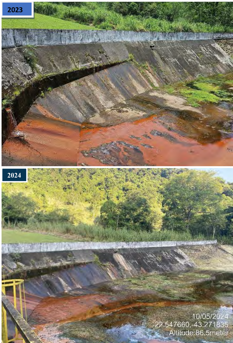
Figura 57: Comparação entre a deterioração do concreto, deslocamento, fissuras e vegetação na parede lateral durante as inspeções de 2023 e 2024.
