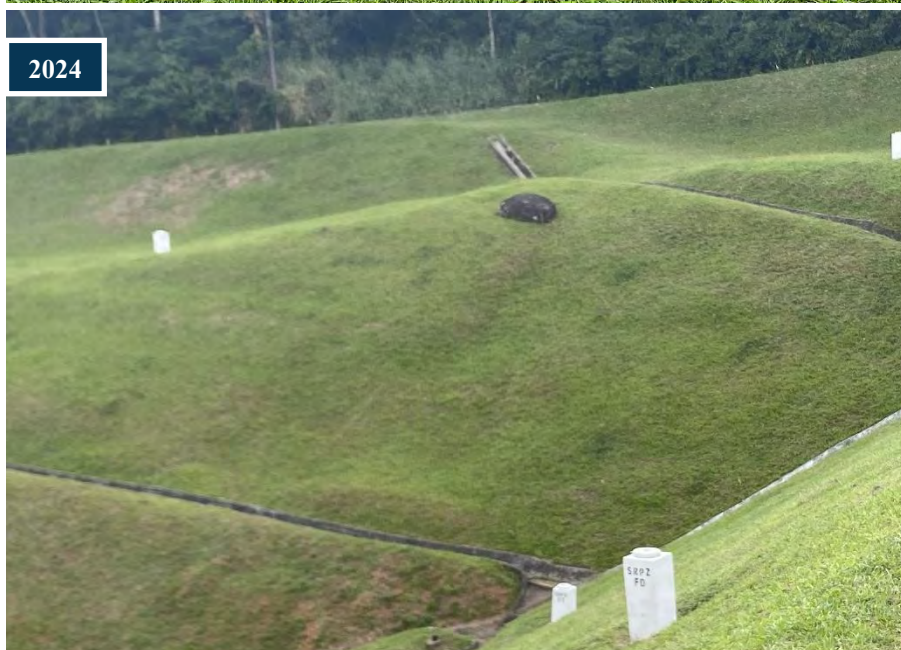
Figura 35: Comparativo entre a presença do matacão na ombreira a jusante durante as inspeções de 2023 e 2024.
