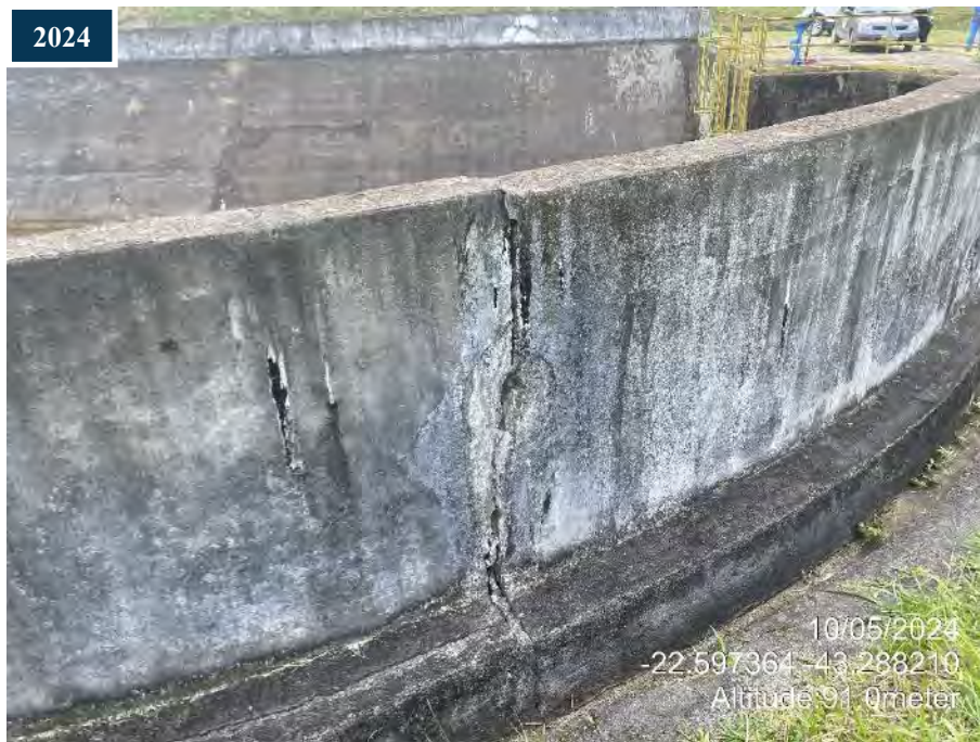
Figura 58: Comparativo entre as fissuras e desalinhamento no muro de proteção
