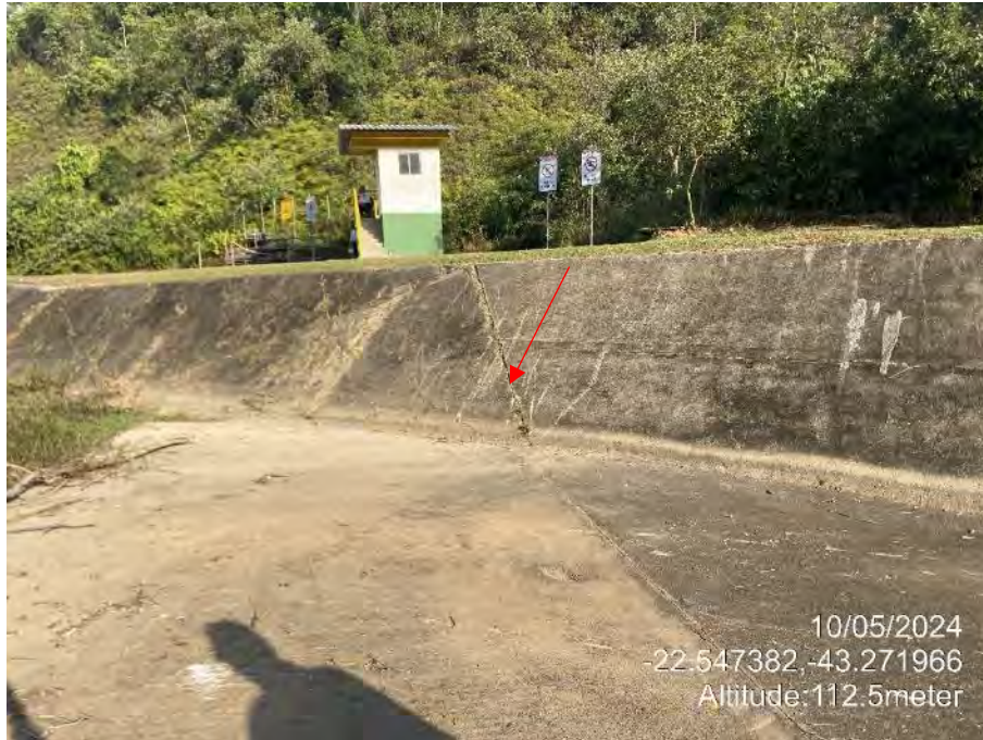
Figura 39: Defeito na junta de concretagem no muro lateral esquerdo do vertedouro.
