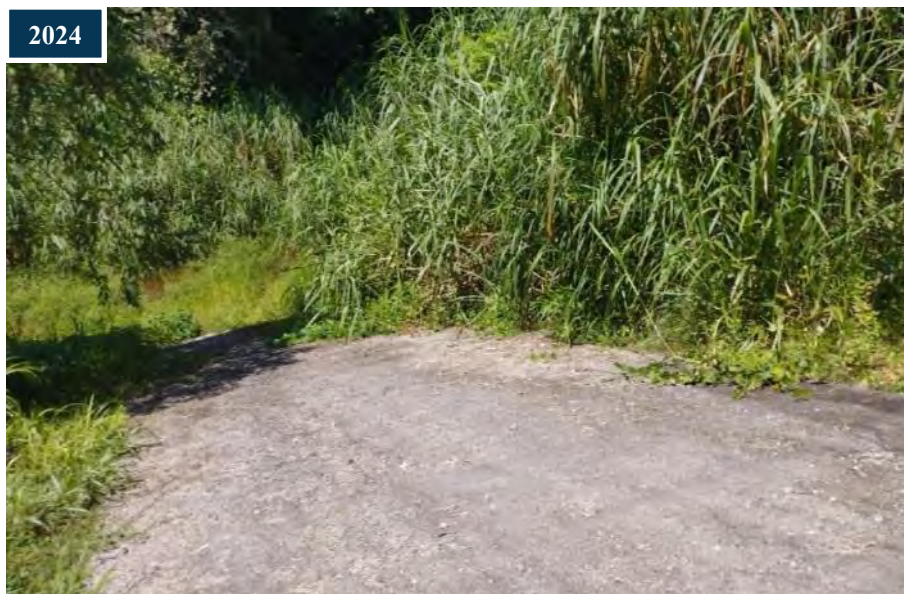
Figura 20: Comparativo entre sinais de surgência a jusante da bacia de descarga de fundo da barragem durante as inspeções de 2023 e 2024.
