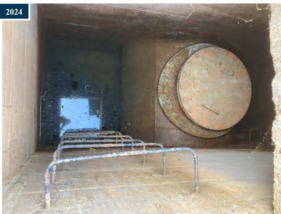
Figura 55: Poço de inspeção do conduto forçado, localizado próximo ao volante da descarga de fundo com acúmulo de água e escadas de acesso sofrendo processo corrosivo.
