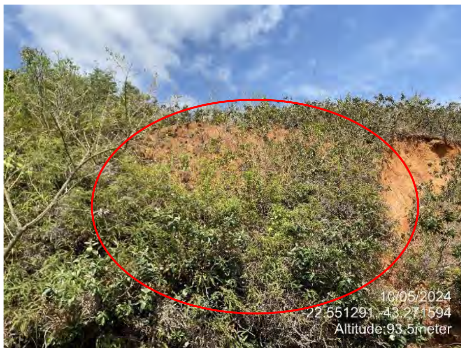
Figura 33: Região com potencial de novos escorregamentos.
