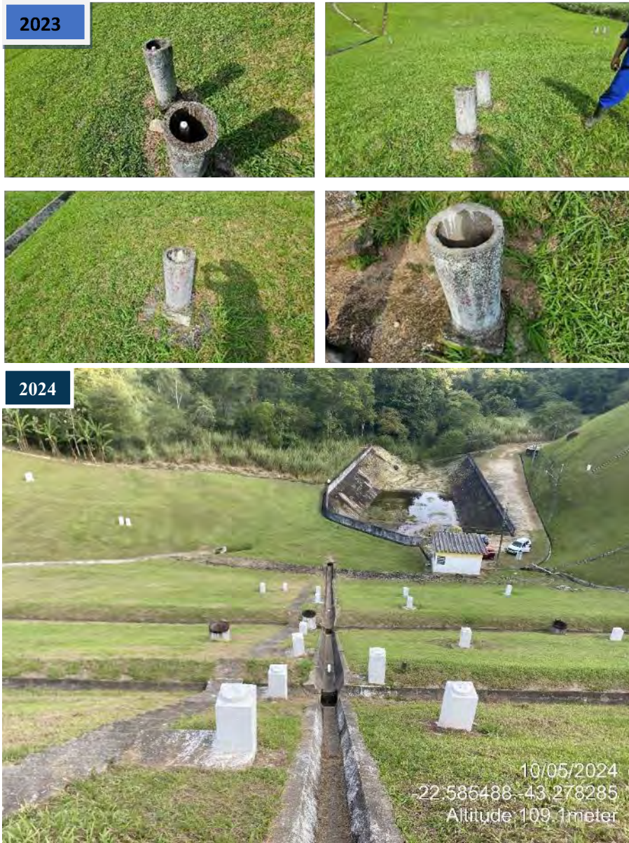
Figura 22: Comparativo dos piezômetros após manutenção realizada.
