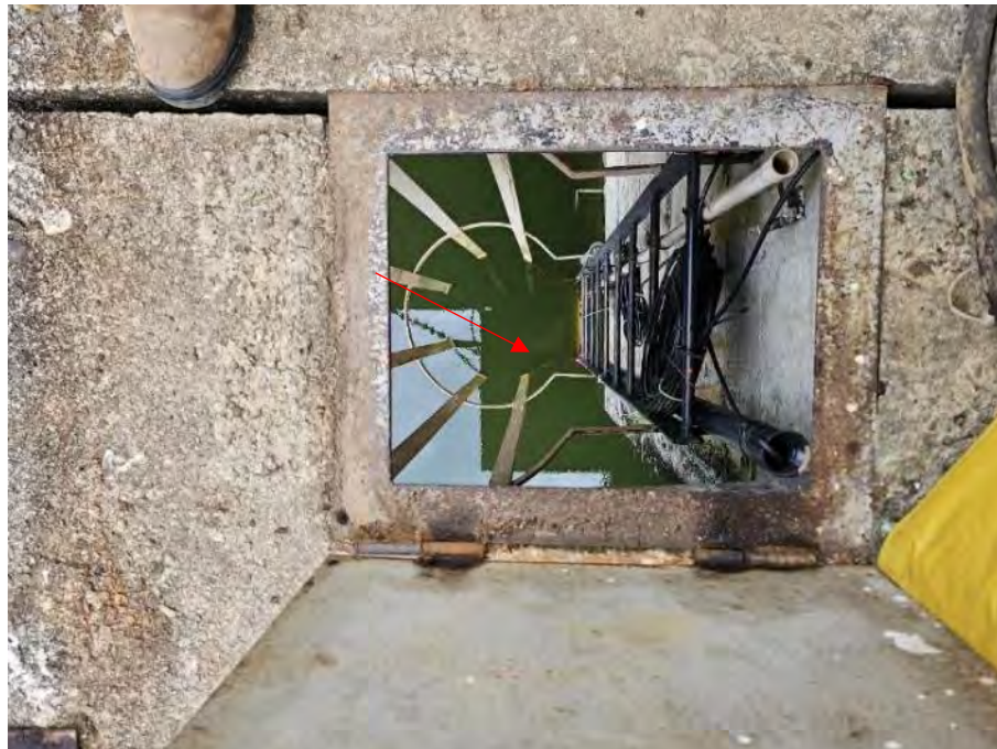
Figura 45: Instrumento de medição do nível d'água do reservatório.
