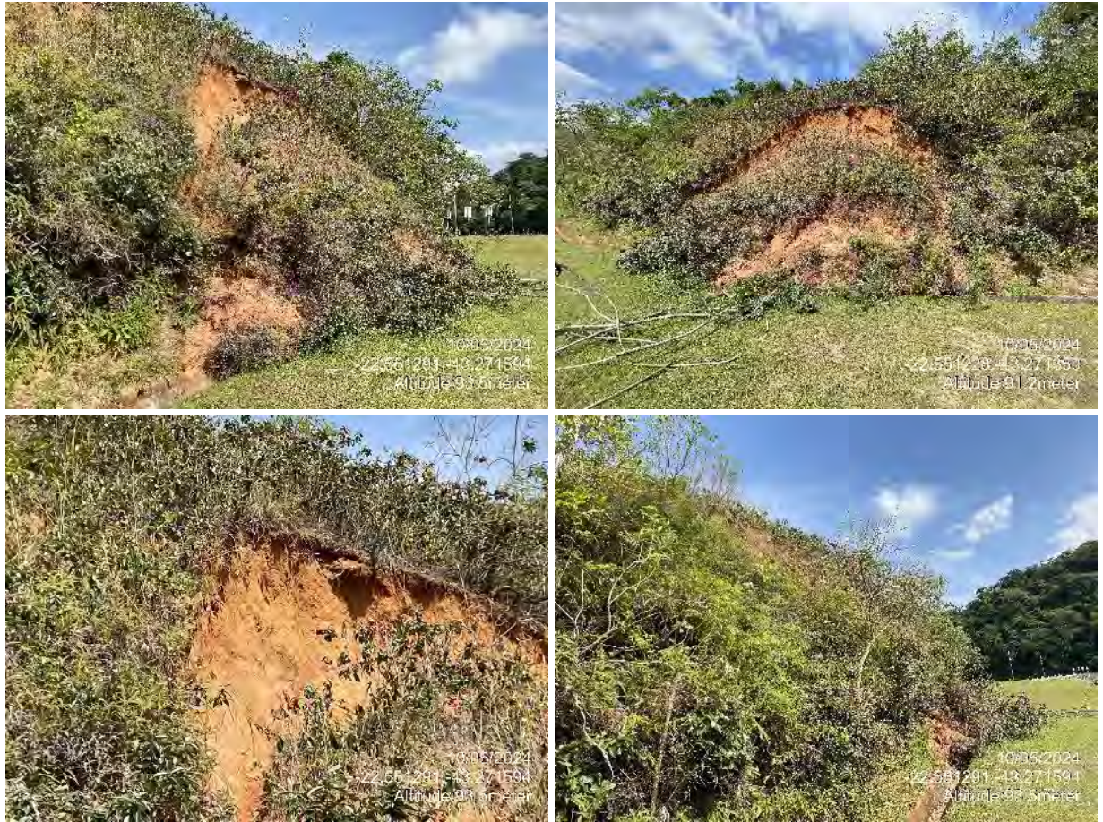
Figura 32: Escorregamento em talude localizado sobre a ombreira esquerda de montante.
